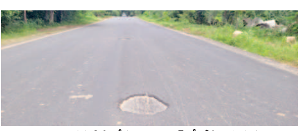
నాగ్గిరి వద్ద టిటి రోడ్డుపై డాంబర్ లేచిపోయిన దృశ్యం
